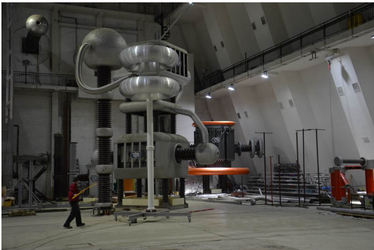
Figura 2: impianto monofase 1600 kV, area di alta tensione
